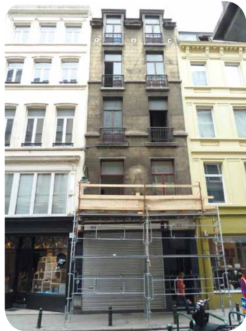
Maison centenaire de la rue des Chartreux - ravalement façade prévu dès septembre 2011.
